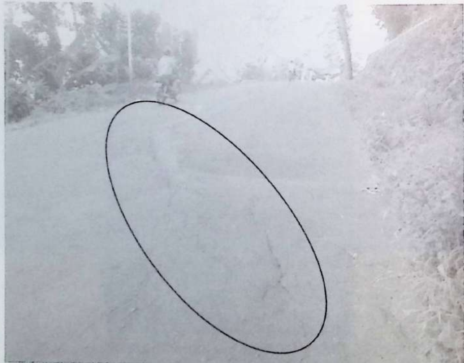
b. Contoh patahan jalan yang terus terjadi dan nampak walau jalan diperbaiki berkali-kali
